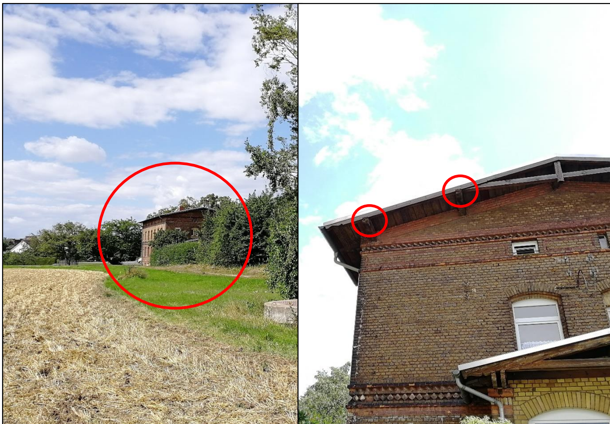
Abb. 6: im Norden angrenzendes Bahnhof mit zahlreichen Bruthöhlen in den Dachbalken (siehe rote Markierungen auf dem rechten Bild)
