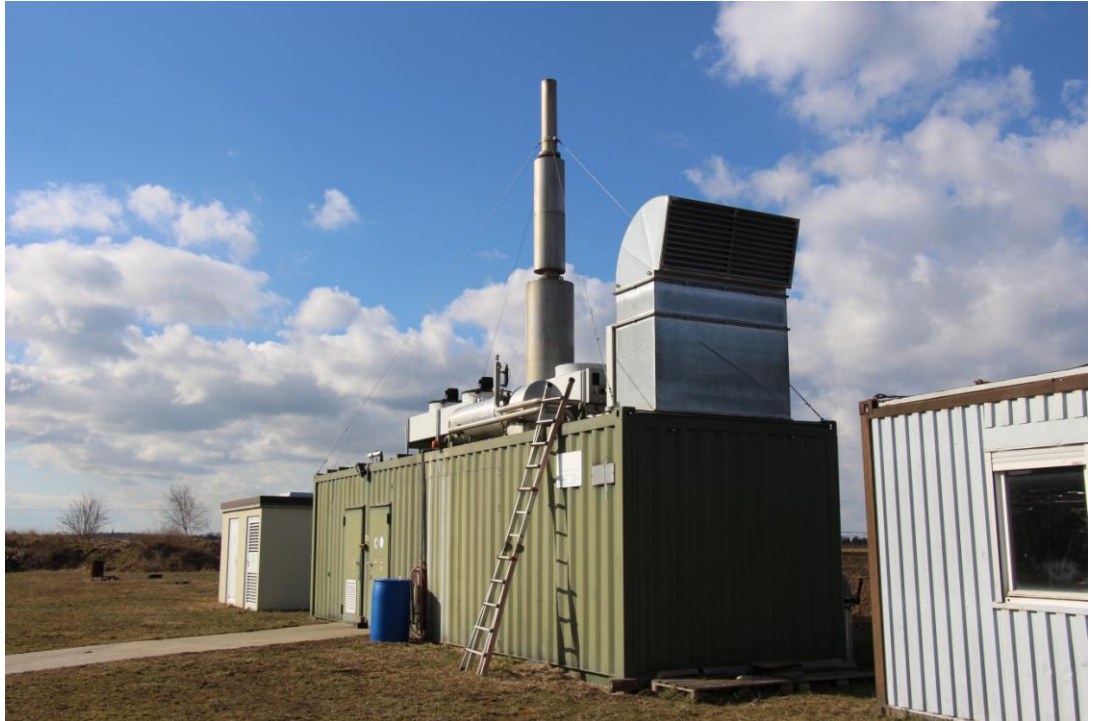
Foto 5: Blick in Richtung Westen auf das derzeit vorhandene Blockheizkraftwerk (BHKW).
