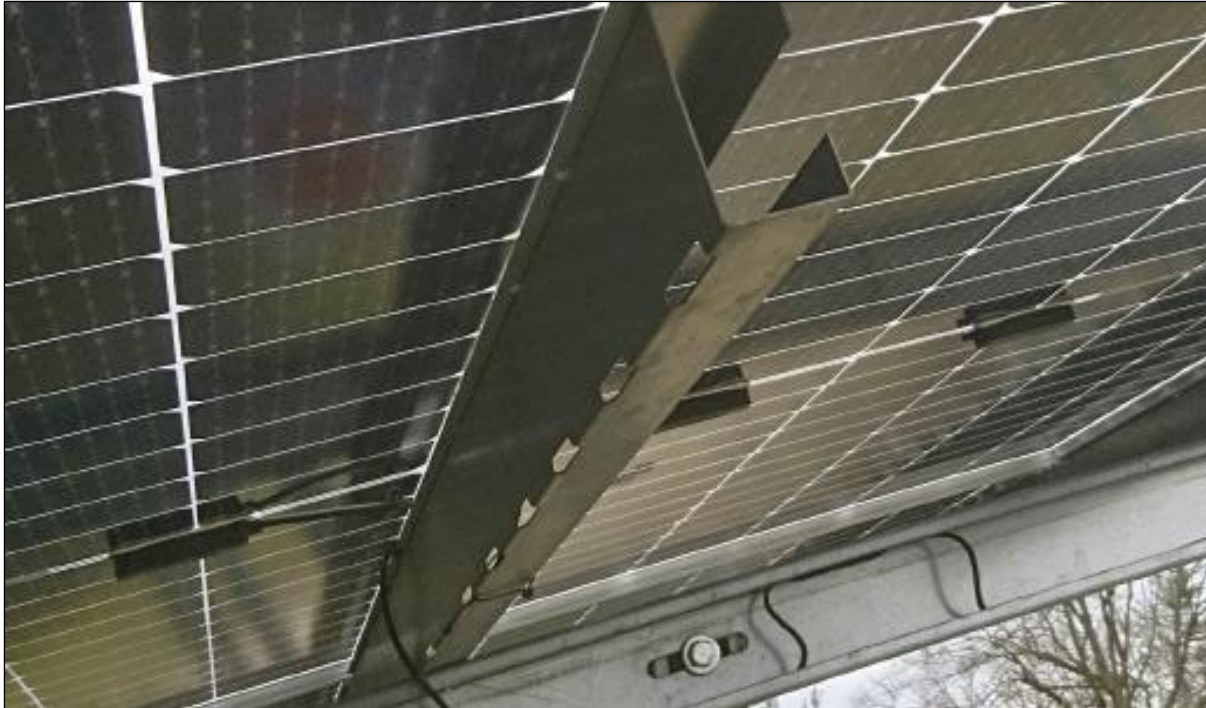
Abb. 3 Regenwasserverteilsystem unter den Modulen (Foto: SUNFARMING)
