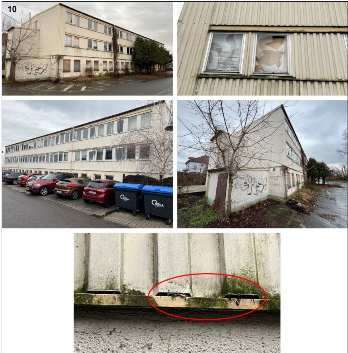
Abb. 15 Ansichten der Gebäude Nr. 10 mit Resten eines Wespennestes (rot)
