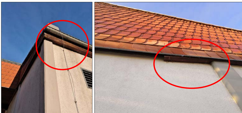
Abb. 10: alte Niststrukturen am Gewerbegebäude, ohne Kot, ohne Nutzungsspuren
